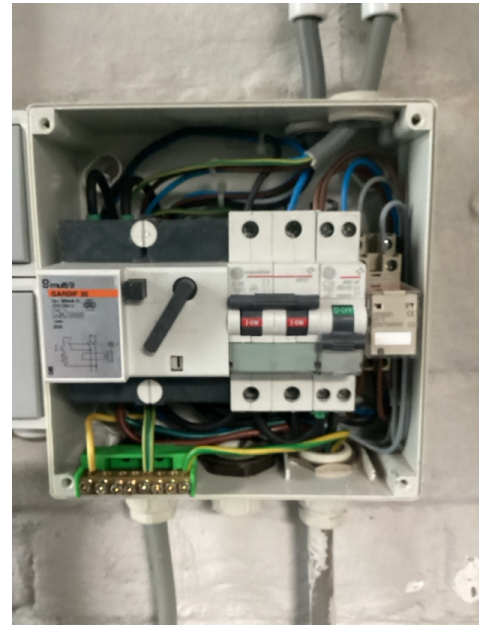
( Tableau électrique - intérieur )
